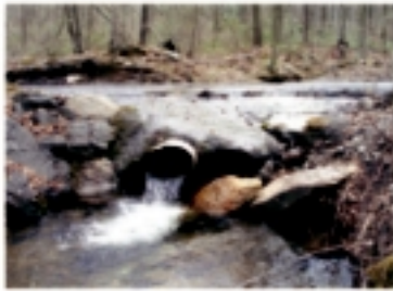
إلقاء مياه الصرف الصحي في الترع شكل (١٣)
